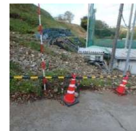
土砂崩れに対する立入禁止措置
