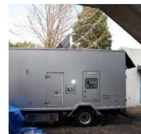
電源車の配備
