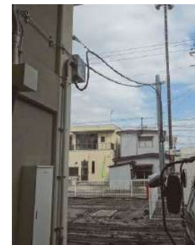
高圧受変電設備が利用できないため、校外の電線より低圧電力を引き込み、仮設電源として利用
